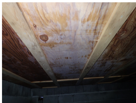
Viser muggsopp på overflate av stubbloft.
