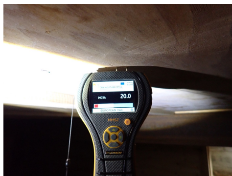
Viser fuktmåling av stubbloft med verdier over det normale.
