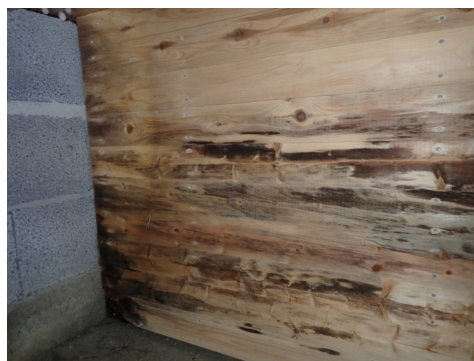
Viser svertesopp og blåved på overflate av skillevegg.
