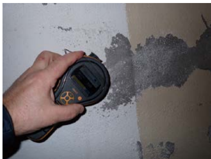
Viser fuktsøk overflate grunnmur med moderate verdier av fukt.
