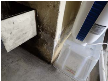
Viser saltutslag på pipestamme.
