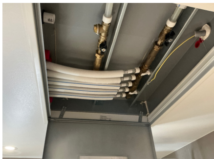
Samlestokk er plassert i baderomshimling.
