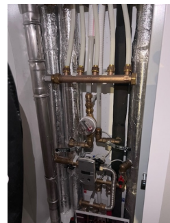
Vanntilførsel er ført til et kombiskap for forbruksvann og varme som er avsatt i soveromsvegg.
