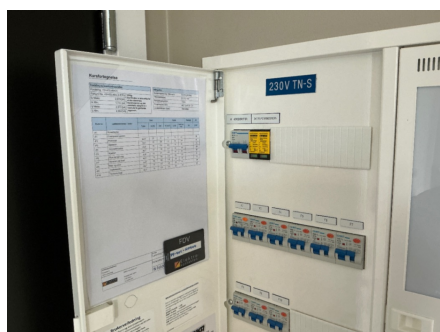
Automatsikringer i sikringsskap plassert i gang.
