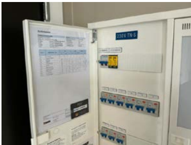
Automatsikringer i sikringsskap plassert i gang.
