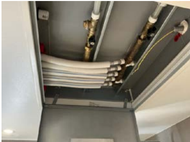
Samlestokk er plassert i baderomshimling.
