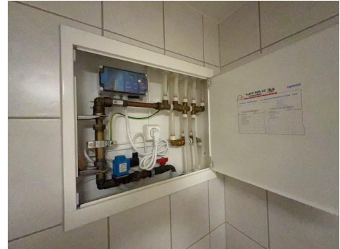
Fordelerskap for vannrør.
