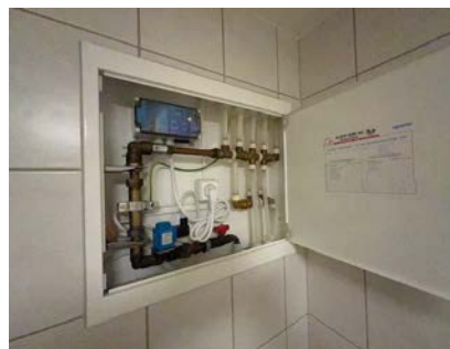
Fordelerskap for vannrør.
