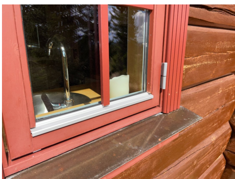
Synlig værslittasje i overflatebehandling.
