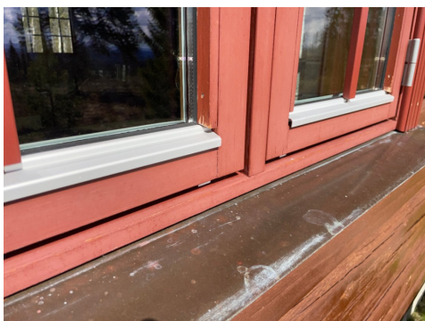
Synlig værslittasje i overflatebehandling.
