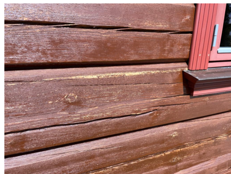
Synlig værslitt overflatebehandling.
