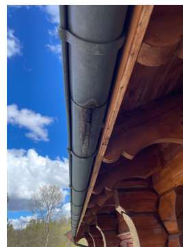
Synlig lekkasje i skjøt takrenne
