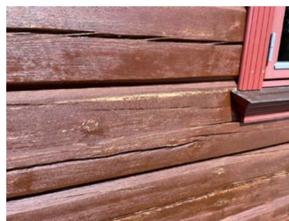
Synlig værslitt overflatebehandling.
