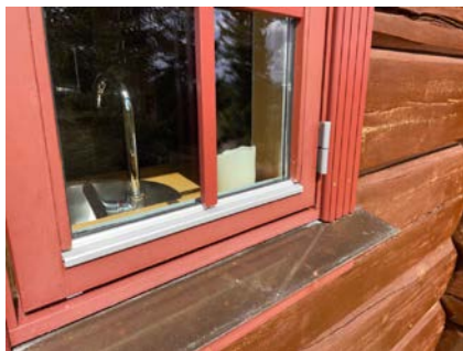
Synlig værslittasje i overflatebehandling.
