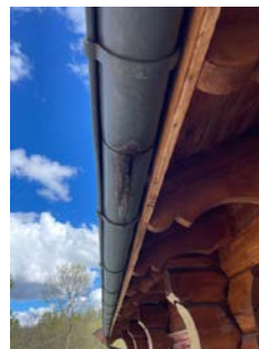
Synlig lekkasje i skjøl takrenne
