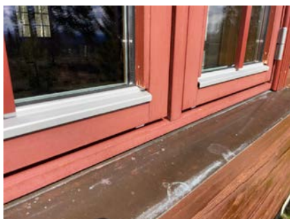
Synlig værslittasje i overflatebehandling.
