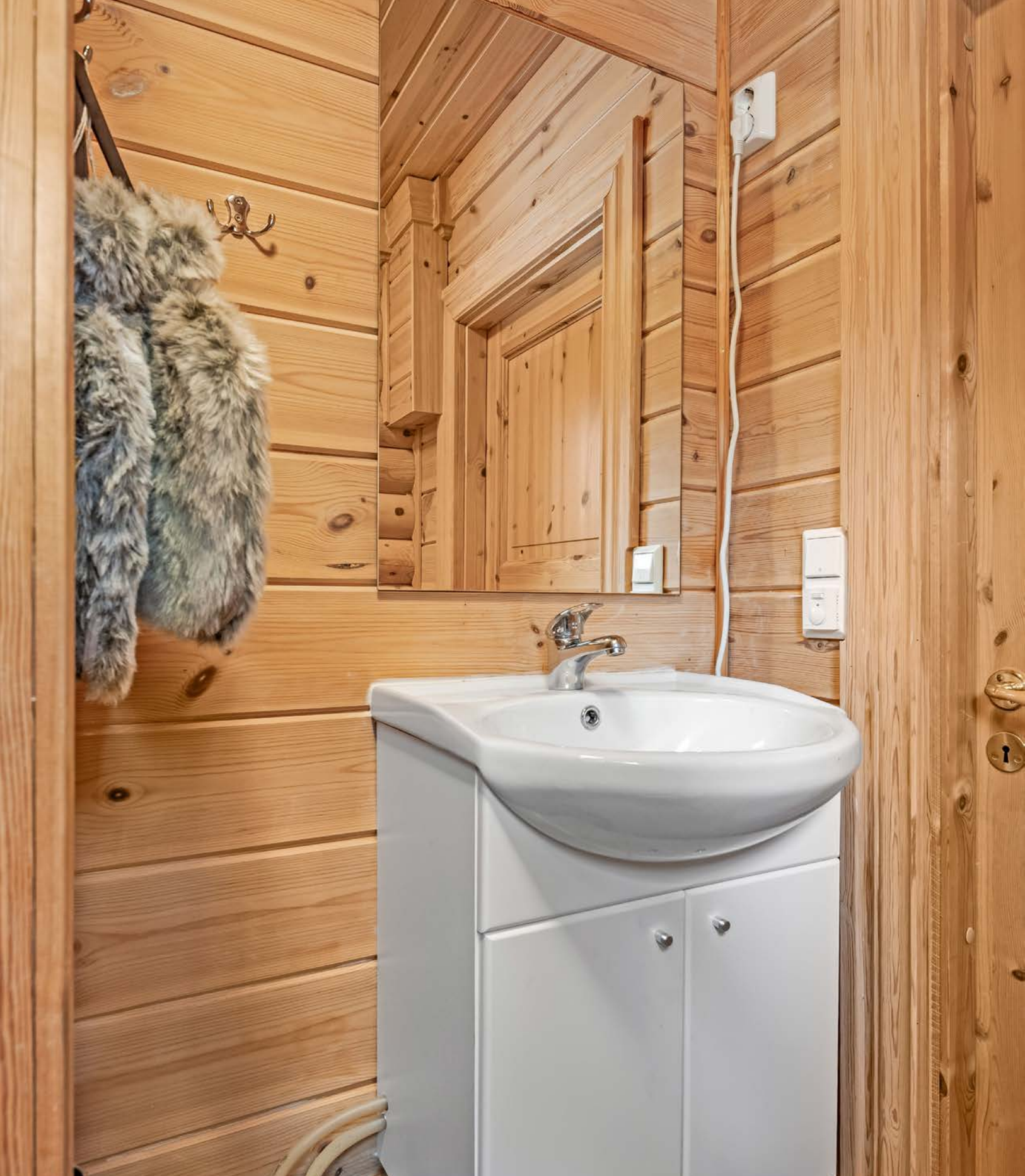
Servantinnredning med underskap og speil i overkant.
