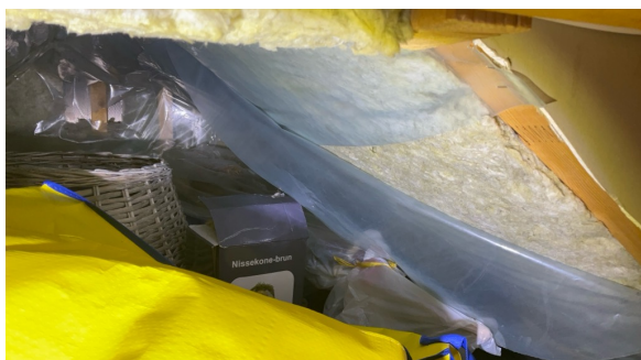
U tett dampsperre på loft over kjøkken
