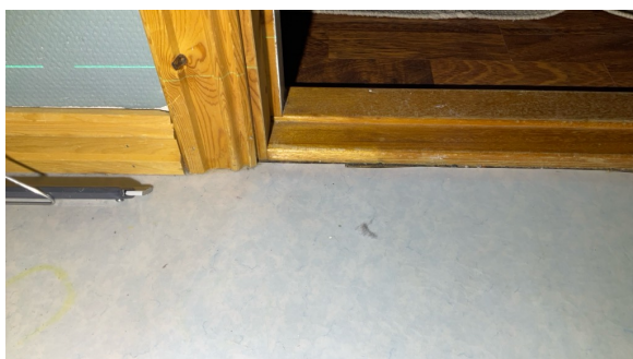
Manglende oppkant på vegg på belegg.
