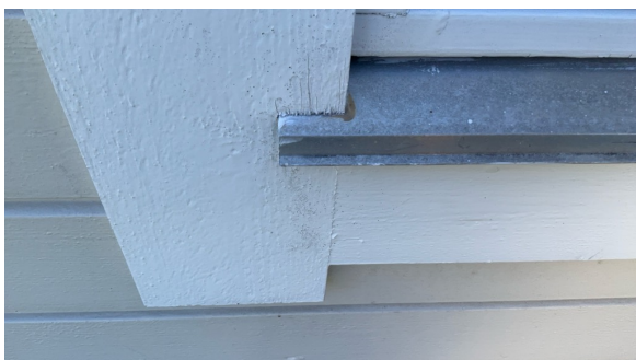
Liten/manglende glippe ned mot vannbrett.
