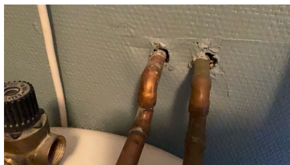
Utette rørgjennomføringer i vegg.
