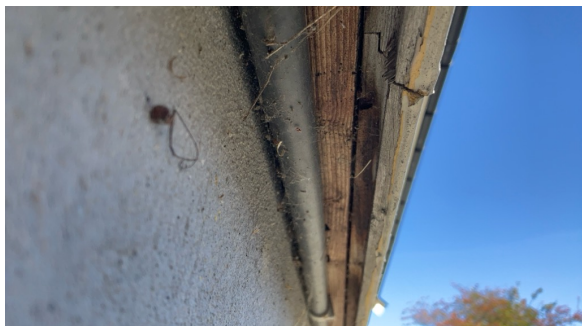
Ikke lufting ned mot grunnmur.
