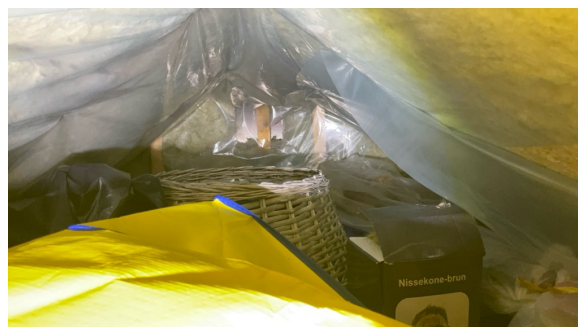
Dårlig tetting rundt ventil på loft.
