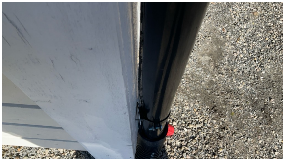
Frosksprengning på nedløpsrør.
