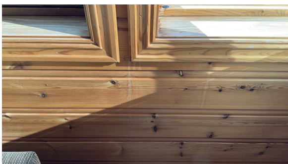
Noe kondensmerker på panel under vindu i loftstue.
