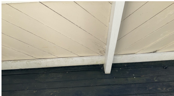
Råte i bordkledning på rekkverk.
