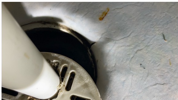
Utett belegg rundt sluk.
