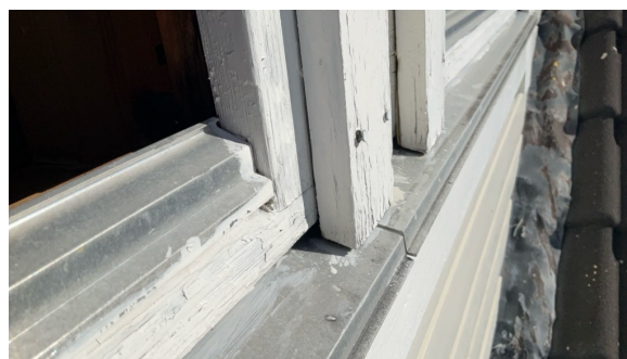
Slitt belistning på vinduer på loft.
