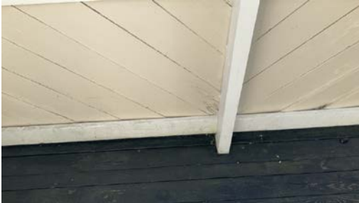
Råte i bordkledning på rekkverk.
