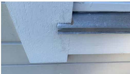
Liten/manglende glippe ned mot vannbrett.
