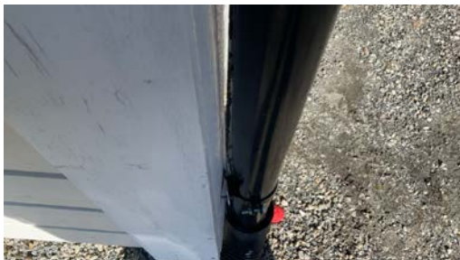
Frostsprengning på nedløpsrør.
