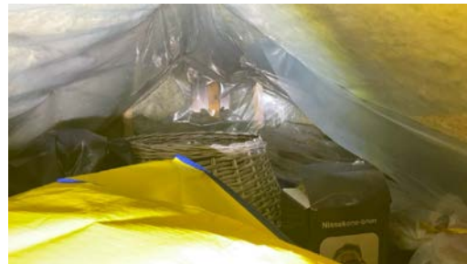
Dårlig tetting rundt ventil på loft.
