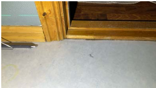
Manglende oppkant på vegg på belegg.
