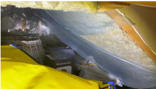
Utett dampsperre på loft over kjøkken
