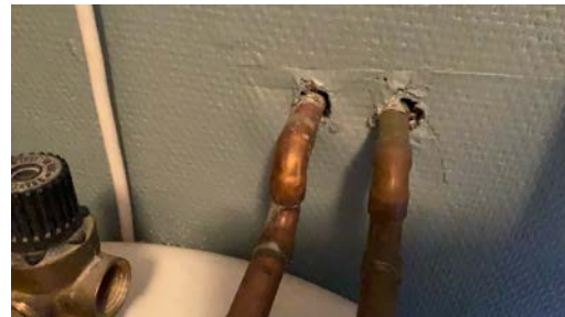
Utette rørgjennomføringer i vegg.
