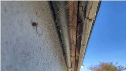
Ikke lufting ned mot grunnmur.
