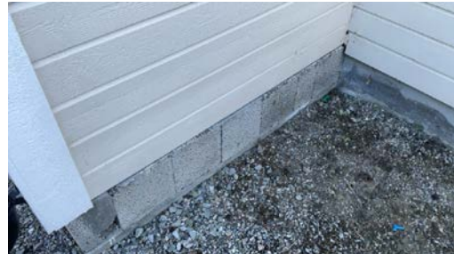
Ringmur stenger for lufting på tilbygg.
