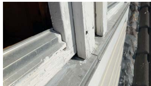
Slitt belistning på vinduer på loft.
