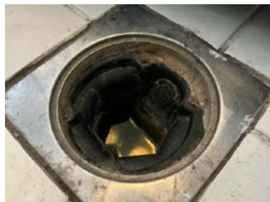
Membran er ikke synlig i sluk og tetting er usikker.
