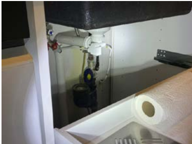
Hovedstoppekran står under vask på vaskerom.
