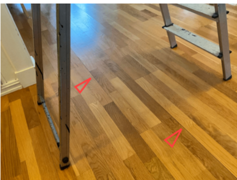
Registrert sprekker i sammenføyninger/skjøter på parkettgulv.
