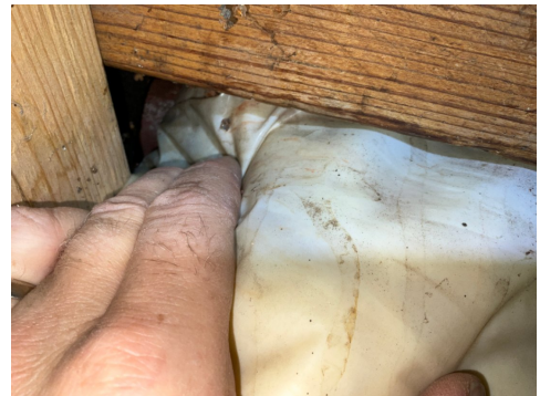
Tegn til manglende lekkasjesikring rundt ventilasjonsrør som er ført opp igjennom yttertak.
