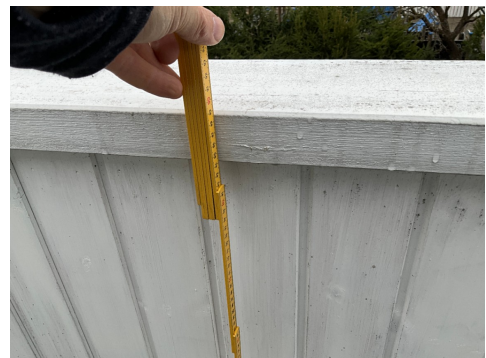
Rekkverkshøyde er målt til lavere enn 1,0 meter
