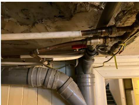
Avløpsrør synlig i kjeller er stemplet produksjonsår 1991
