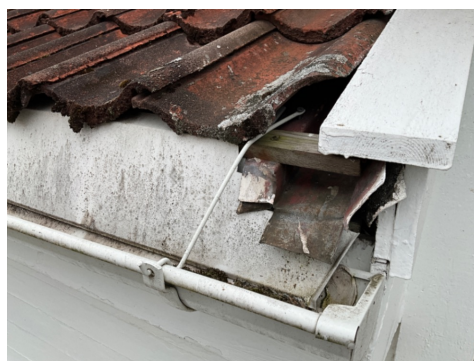
Begynnende råte i lekte under takstein ved taksid mot nord-øst
