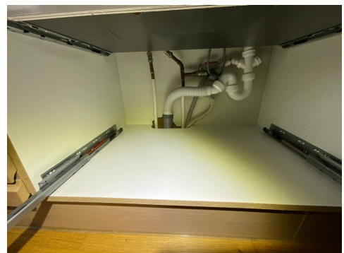
Eldre vannledninger av kobber til kjøkken.
