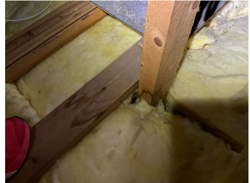
Tegn til kondensutfordringer på loft, fuktskjolder på trevirke.
