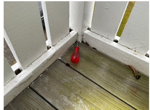
Tilløp til råte i rekkverk på balkong mot nord
