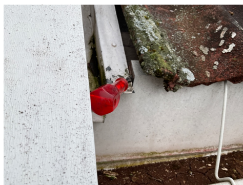
Begynnende råte i lekte under takstein ved taksid mot sør-øst
