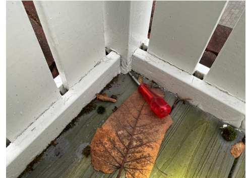
Tilløp til råte i rekkverk på balkong mot nord
