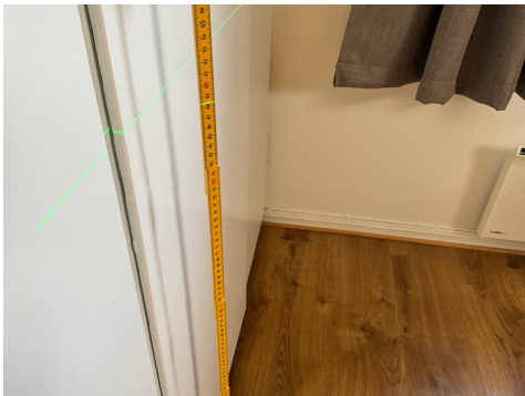
Stikkprøver av planavvik. Måling av planavvik i soverom mot sør-øst. Topp laserstrek viser 885mm.
