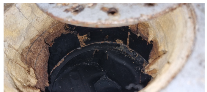
Tegn til at det er slukmansjett ned i sluket, men det er ikke tegn til klemring.
