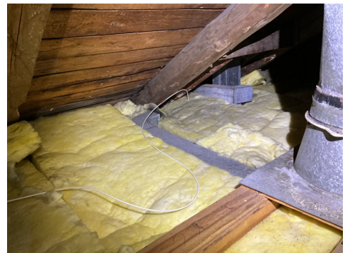
Tegn til kondensutfordringer på loft, fuktskjolder på trevirke/undertak. Det er også et gammelt ventilasjonssystem på loftet som ser ut til å ikke være i funksjon.
