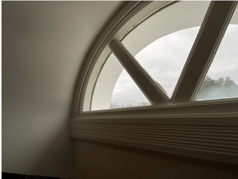
Sprekker rundt buvindu i stue.
