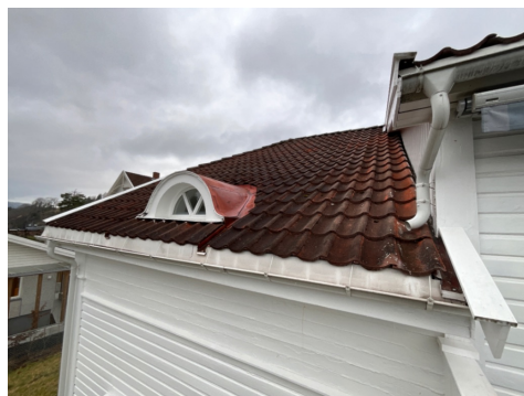
Buevindu på takflate mot vest, i stue
