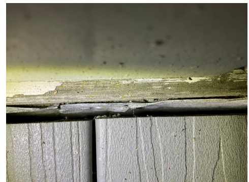
Ser ut til å være tettesjikt av metallplater under tilfarere og komposittgulv.
