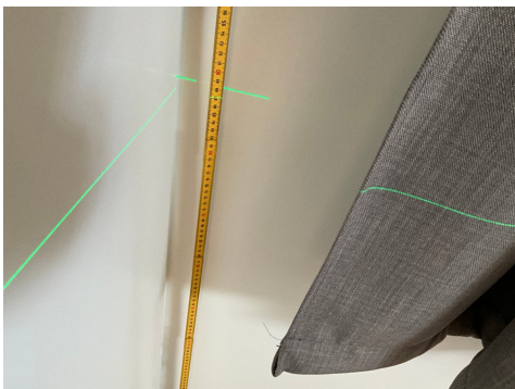
Stikkprøver av planavvik. Måling av planavvik i soverom mot sør-øst. Topp laserstrek viser 870mm. 15 mm høydeforskjell over rommet.
