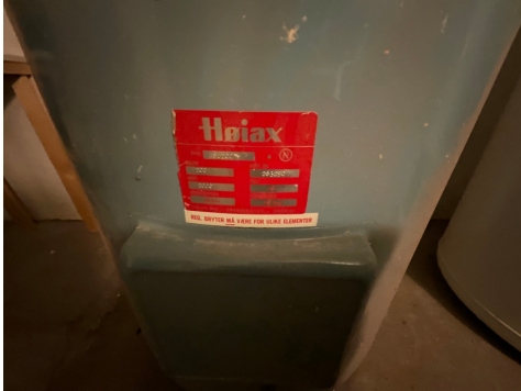
Eldre varmtvannstank, mer enn 30 år gammel.
