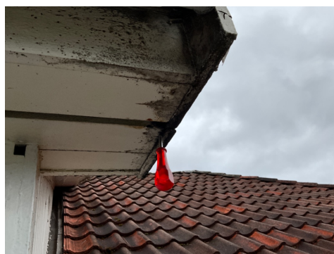
Begynnende råteskade i gesimskasse/vindski på oppløft mot sør.
