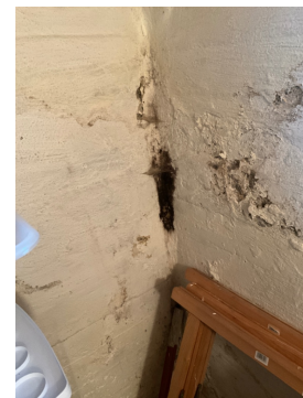
Tegn til noe fuktgjennomtrengning på ett punkt i kjellerbod.
