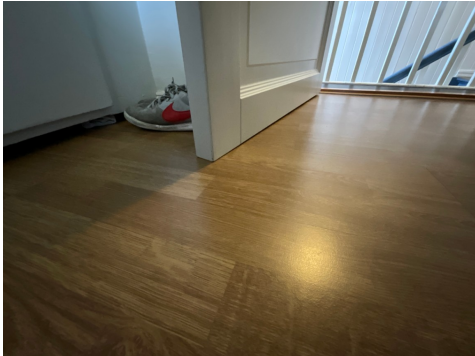
Dørblad tar i gulv ved full åpning.
