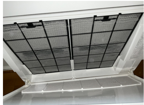
En del støv i filter på varmepumpen
