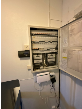
Sikringskap i felles gang/trapperom
