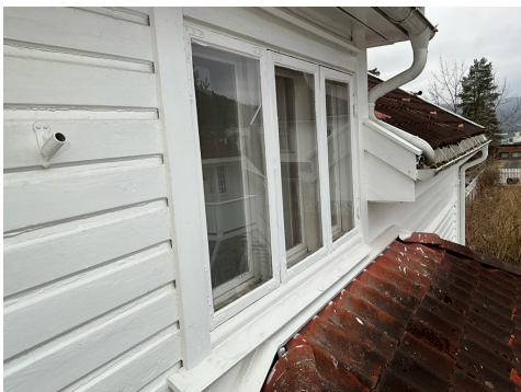
Eldre 3-fags vindu i trapperom/toalettrom
