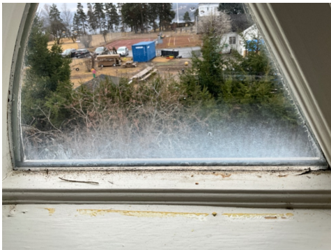
Tegn til fuktskader og punktert glass i vindu i soverom
