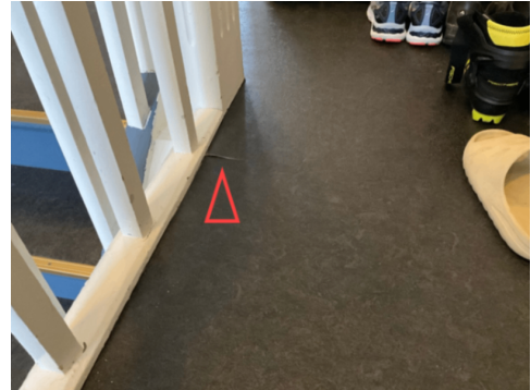
Bulning på gulvbelegg
