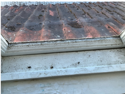
Muggvekst på vindu tyder på kondensproblematikk.
