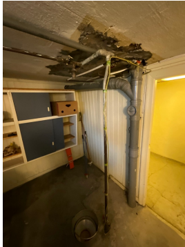
Hovedstoppekran i bod i kjeller
