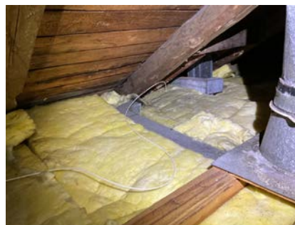
Tegn til kondensutfordringer på loft, fuktskjolder på trevirke/undertak. Det er også et gammelt ventilasjonssystem på loftet som ser ut til å ikke være i funksjon.
