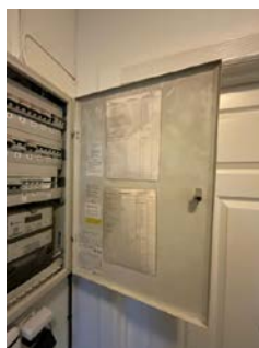
Sikringskap i felles gang/trapperom, kursoversikt
