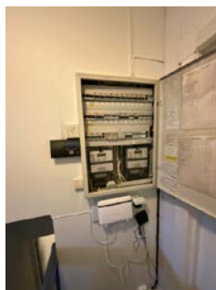
Sikringskap i felles gang/trapperom
