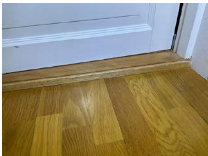
Dør til soverom mot sør-øst tar i karm
