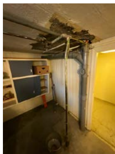
Hovedstoppekran i bod i kjeller
