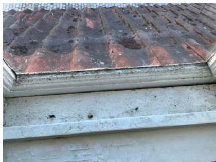
Muggvekst på vindu tyder på kondensproblematikk.
