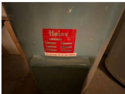
Eldre varmtvannstank, mer enn 30 år gammel.
