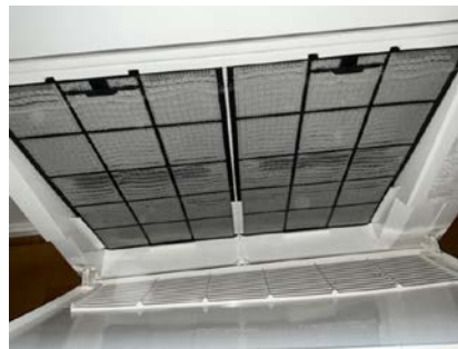
En del støv i filter på varmepumpen
