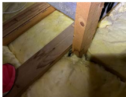
Tegn til kondensutfordringer på loft, fuktskjolder på trevirke.
