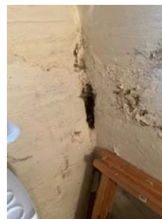
Tegn til noe fuktgjennomtrengning på ett punkt i kjellerbod.
