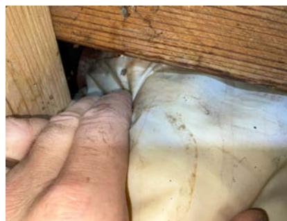
Tegn til manglende lekkasjesikring rundt ventilasjonsrør som er ført opp igjennom yttertak.
