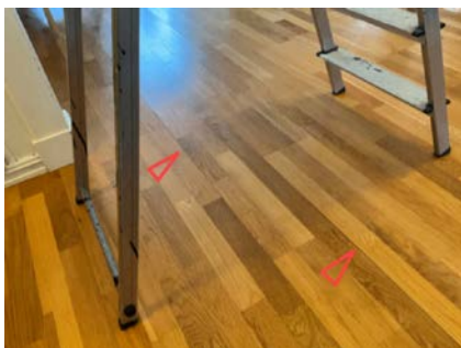
Registrert sprekker i sammenføyninger/skjøter på parkettgulv.
