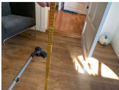
Stikkprøver av planavvik. Måling av planavvik i soverom mot sør-øst. Topp laserstrek viser 889mm. 10 mm høydeforskjell over 2 meter.
