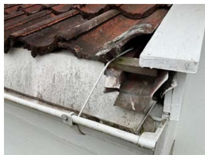
Begynnende råte i lekte under takstein ved taksid mot nord-øst
