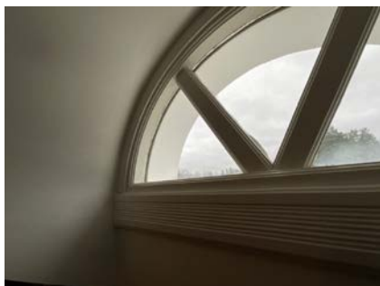
Sprekker rundt buevindu i stue.
