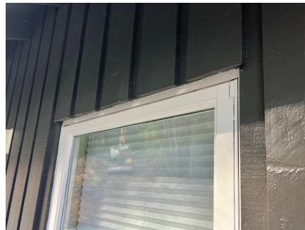
Ikke vannbrett over vindu.
