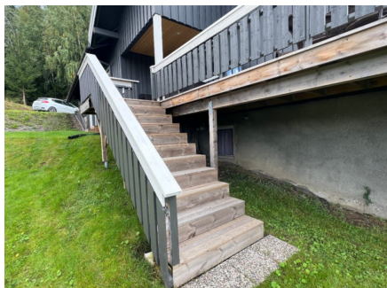
Ikke rekkverk på en side.
