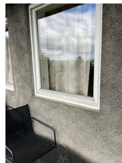
Vinduer i sokkel/kjelleruten vannbrett.
