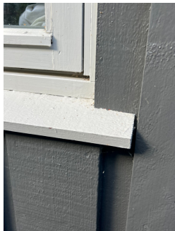
Sideomramning ned mot vannbrett og ikke beslag.
