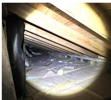
Konstruksjon/Loft: Ingen lufting i raftet.
