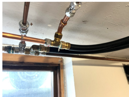
Åpent rør i rør system.
