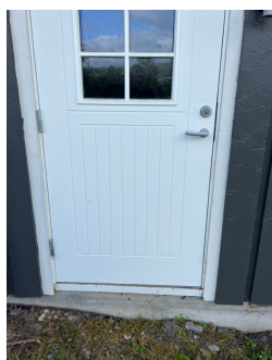
Ytterdør i fm garasje uten beslag
