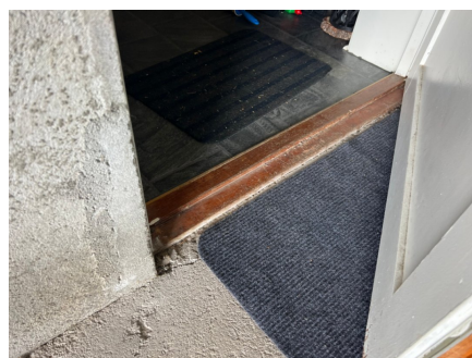
Kjellerdør: Ikke beslag under døren.
