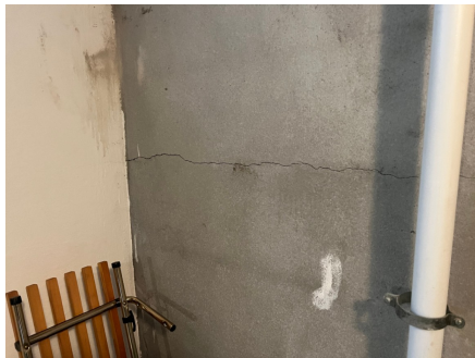
Horizontalsprekk i grunnmur- kjellerdel.
