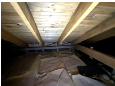
Konstruksjon/Loft: Ingen lufting i raftet.
