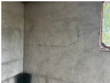
Setningssprekk i mur ved inngang til sokkel/kjeller.
