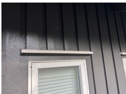
Kledning står ned mot vannbrett over vindu.
