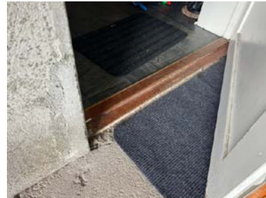
Kjellerdør: Ikke beslag under døren.
