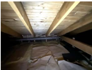
Konstruksjon/Loft: Ingen lufting i raftet.
