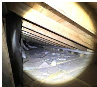
Konstruksjon/Loft: Ingen lufting i raftet.
