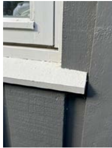
Sideomramming ned mot vannbrett og ikke beslag.
