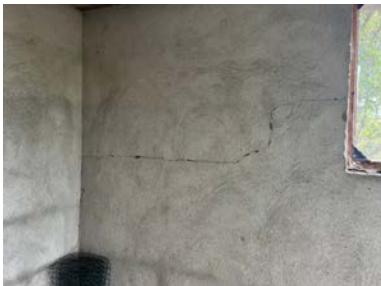
Setningssprekk i mur ved inngang til sokkel/kjeller.
