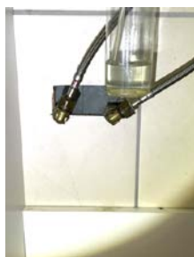
Rørgjennomføring i innredning.
