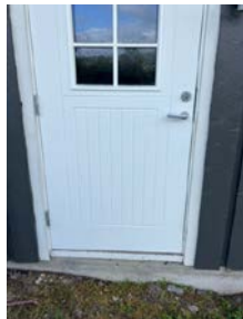
Ytterdør i fm garasje uten beslag
