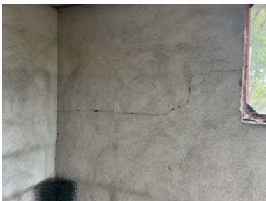
Setningssprekk i mur ved inngang til sokkel/kjeller.
