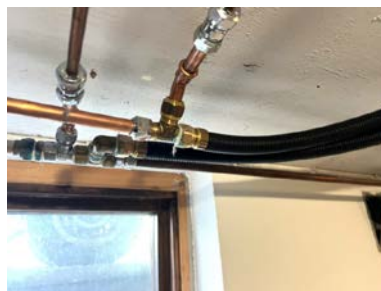
Åpent rør i rør system.
