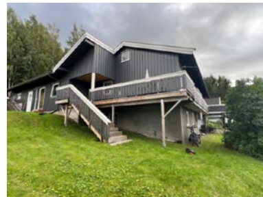
Fall langs gavlvegg og ut fra boligen.
