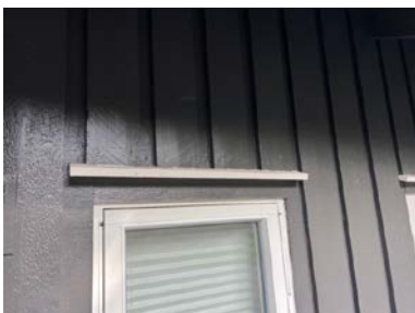
Kledning står ned mot vannbrett over vindu.
