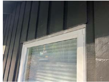
Ikke vannbrett over vindu.
