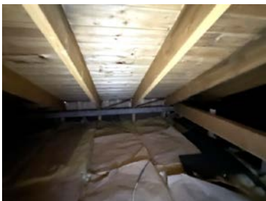
Konstruksjon/Loft: Ingen lufting i raftet.
