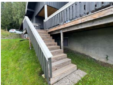
Ikke rekkverk på en side.
