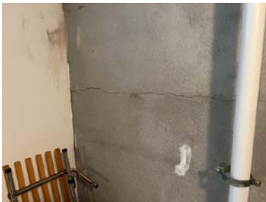
Horisontalsprekk i grunnmur- kjellerdel.
