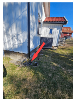
Ikke tilfredsstillende bortledning av takvann
