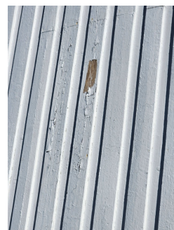
Skader på overflatebehandling.
