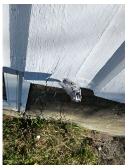
Eksempel på råteskadet kledningsbord.
