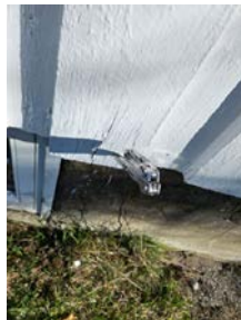
Eksempel på råteskadet kledningsbord.
