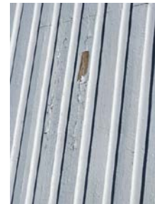
Skader på overflatebehandling.
