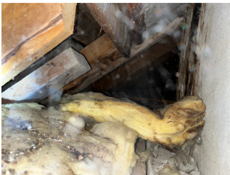
Gamle fuktmerker ved pipe.
