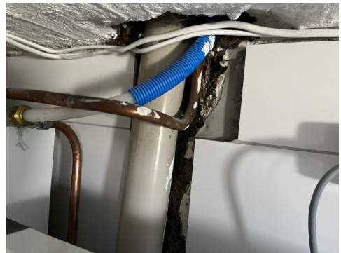
Manglende tetting ved rør.
