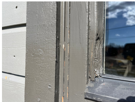
Råteskade i vindu
