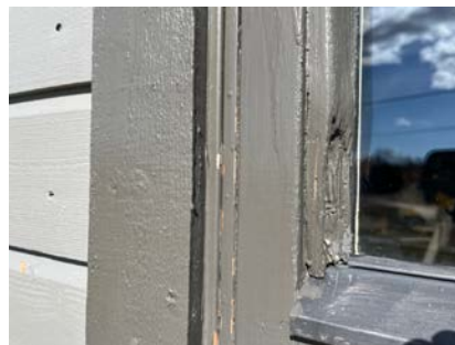
Råteskade i vindu
