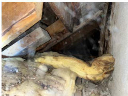
Gamle fuktmerker ved pipe.
