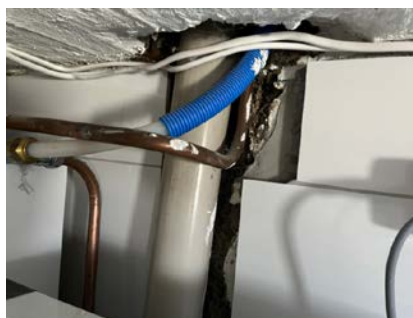
Manglende tetting ved rør.
