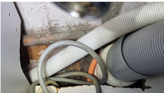
Avløpsrør av plast med overgang til soil.
