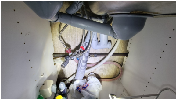
Vannledninger av kobber og plast
