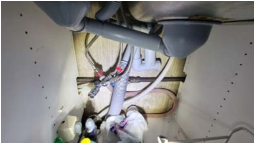
Vannledninger av kobber og plast
