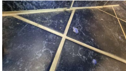
Sår/hakk i fliser.
