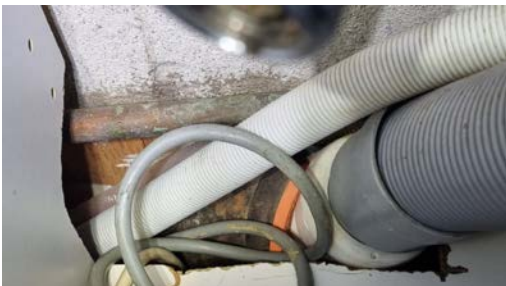
Avløpsrør av plast med overgang til soil.
