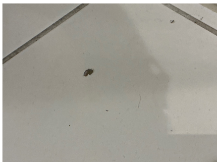
Skade på flis på gulv.
