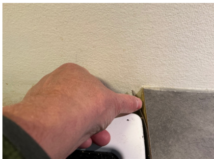
Kant-list på benkeplate ved komfyr er løsnet.
