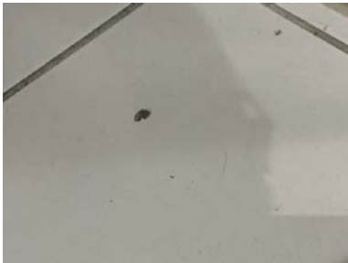
Skade på flis på gulv.
