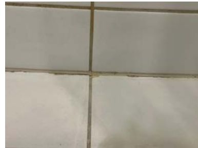
Glippe i silikon fuge mellom gulv og vegg,
