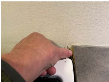
Kant-list på benkeplate ved komfyr er løsnet.
