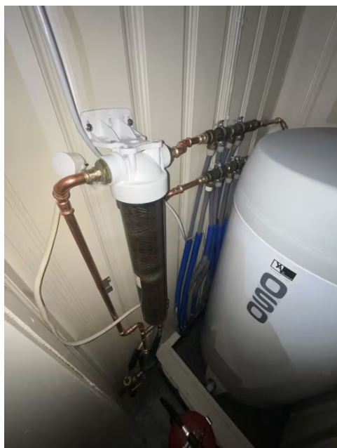
Viser filter, vannrør med rør i rør system fra åpen fordeler plassert i gang og frem til sanitærinstallasjoner på badetrom og kjøkken.
