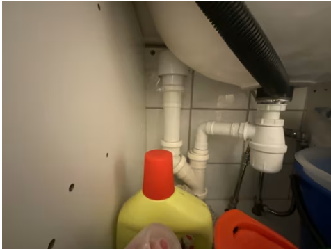
Lufting med vakumventil i baderomsinnredning.
