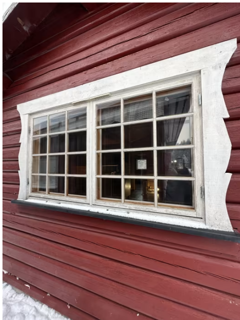
Eldre vinduer framstår med vedlikeholdsbehov.
