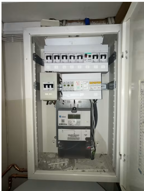
Viser sikringskap plassert i gang.
