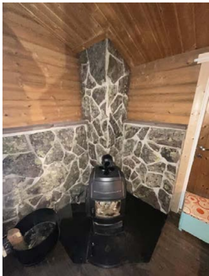
Viser ildsted plassert i stue.
