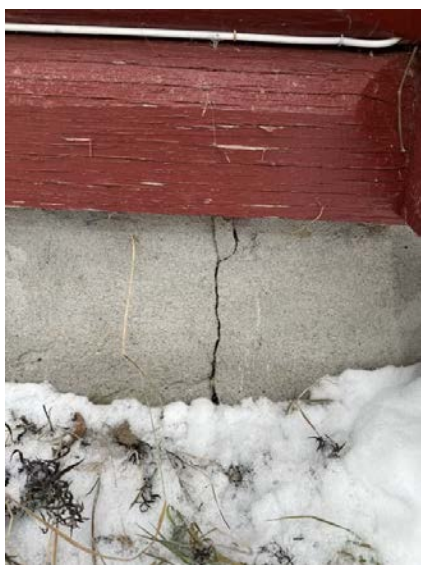
Det registreres riss/ sprekker i grunnmuren.
