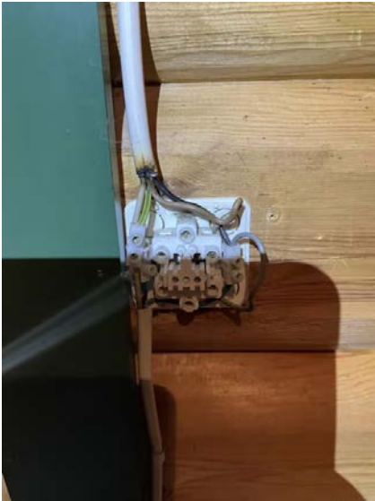
Det er misfarging / termiske skader på komponenter som indikerer varmgang.
