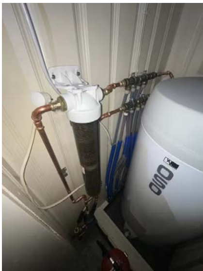
Viser filter, vannrør med rør i rør system fra åpen fordeler plassert i gang og frem til sanitærinstallasjoner på baderom og kjøkken.
