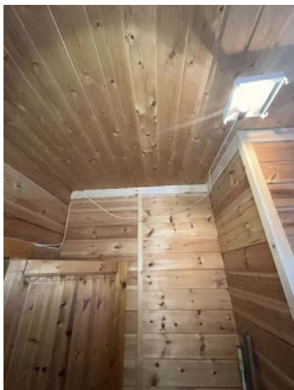
Det registreres dårlig innfesting på kabler.
