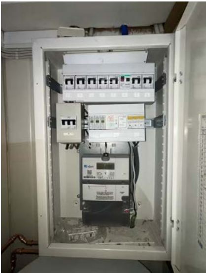
Viser sikringsskap plassert i gang.
