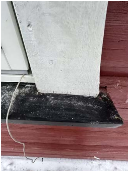
Det er påvist avvik ved omramming. Liten/ingen avstand mellom trepanel og beslag, fare for fuktopptrekk.
