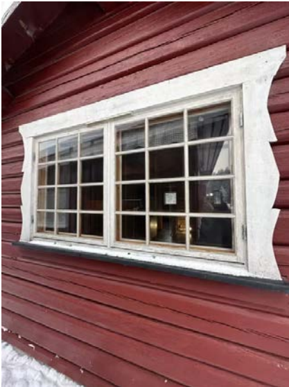
Eldre vinduer framstår med vedlikeholdsbehov.
