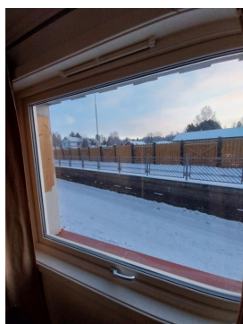
Soveromsvindue påvist fra 2022.
