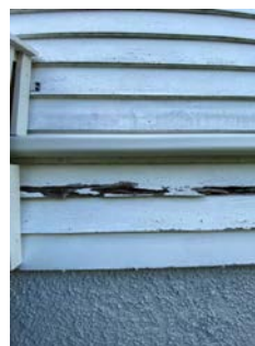
Råteskader i kledning mot nord.
