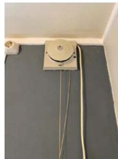
Mekanisk avtrekk ut i vegg, ikke funksjonstestet.
