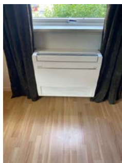
Varmepumpe innerdel hovedetasje.
