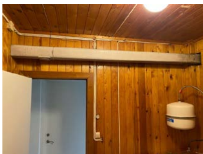
Avtrekk-kanal i asbest.
