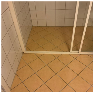
Dusj med skyvedører, spalte ved gulvskinne
