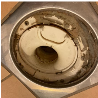
Sluk av plast, klemring _ mørtel / ukjent type tettesjikt
