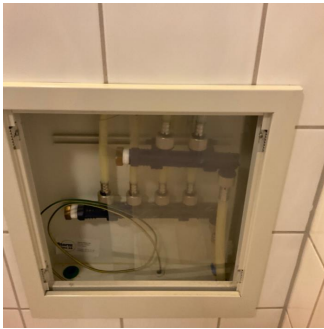
Fordelerskap i vegg på badetrom
