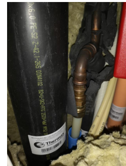
Stigerør i sjakt _ plastrør med messingkopling
