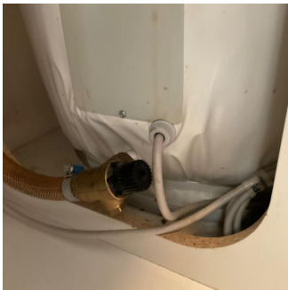
Installert i hjørne av kjøkkenbenk
