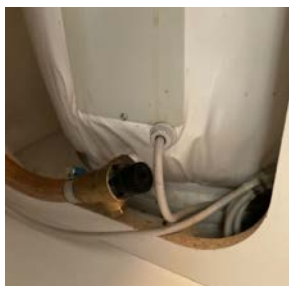
Installert i hjørne av kjøkkenbenk
