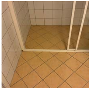
Dusj med skyvedører, spalte ved gulvskinne
