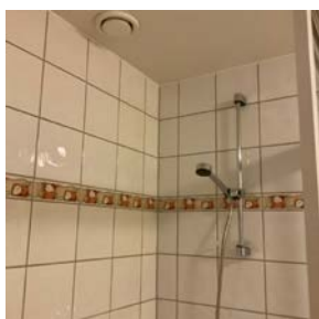
Avtrekksventil i himling over dusjhjørnet
