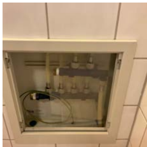
Fordelerskap i vegg på badetrom
