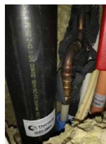
Stigerør i sjakt _ plastrør med messingkopligng
