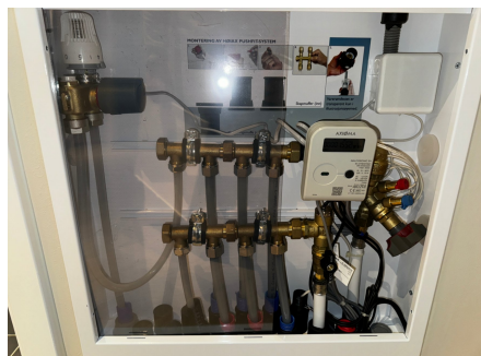
Fordelerskap vannbåren varme
