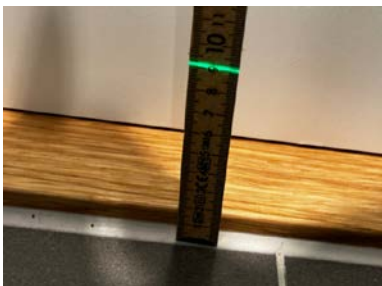
Fallforhold ca. 90 mm overkant gulv ved terskel
