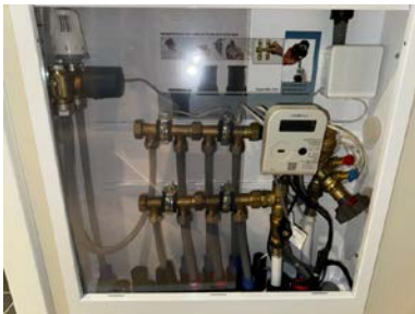
Fordelerskap vannbåren varme
