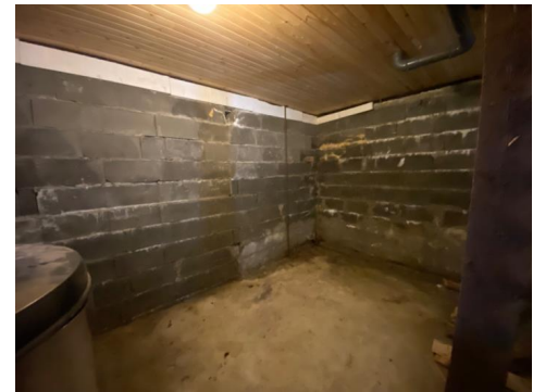
Saltutslag på vegger.
