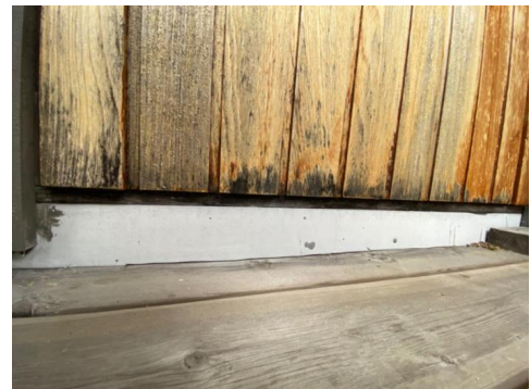
Råteskader i nedre del på døren.
