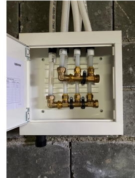
Fordelingsskap til bad fra 2017.
