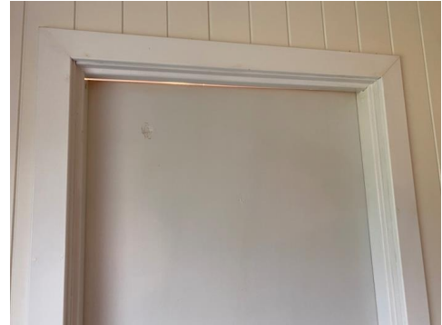
Skade i overflate dørbled.
