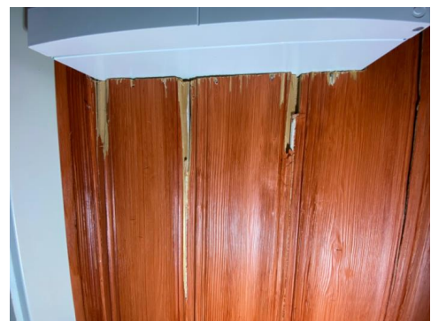
Panel på vegg i yttergang har en del skader.
