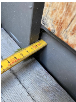
10 mm. åpning mellom dekkbord og beslag.
