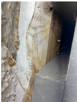
Manglende lusing/musebånd på vegg mot øst.
