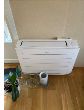
Varmepumpe, innvendig del i stue.
