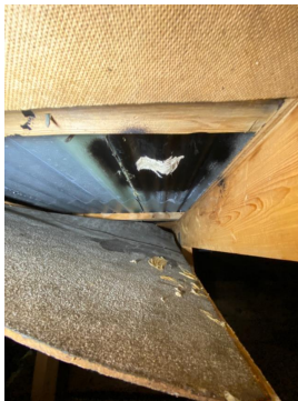
Ikke fagmessig tetting av yttertak.
