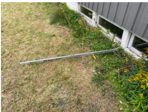
Fall på terrenget.
