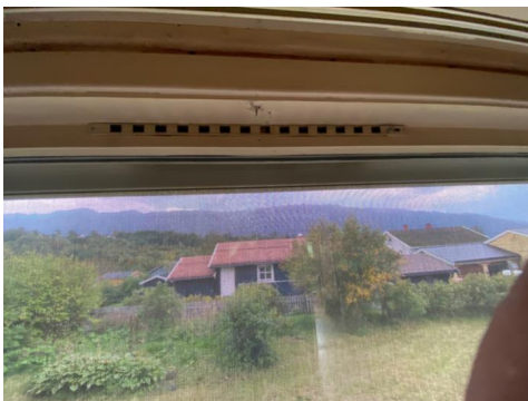
Ventiler i vinduer.
