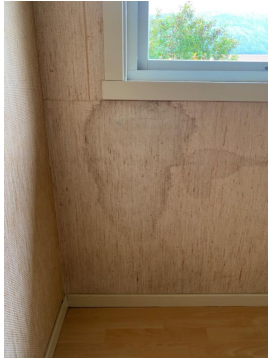
Fuktskade på vegg etter tidligere lekkasje.
