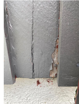
Råteskadd/oppsruknet bordkledning mot øst.
