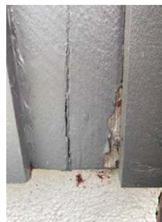
Råteskadd/oppsrukket bordkledning mot øst.
