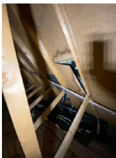
Su-plater har løsnet på enkelte plasser.
