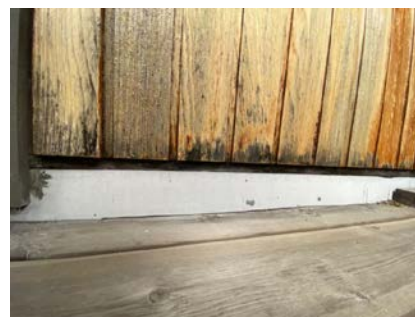
Råteskader i nedre del på døren.
