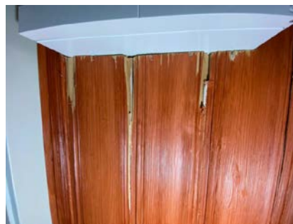
Panel på vegg i yttergang har en del skader.
