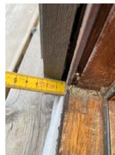
Glippe mellom utvendig omramming.
