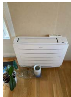
Varmepumpe, innvendig del i stue.
