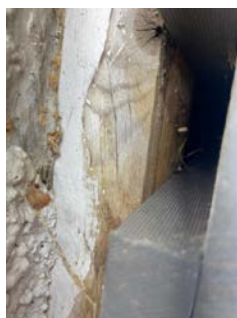
Manglende lusing/musebånd på vegg mot øst.
