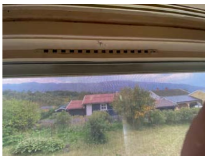
Ventiler i vinduer.
