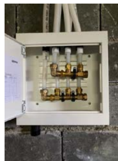
Fordelingsskap til bad fra 2017.
