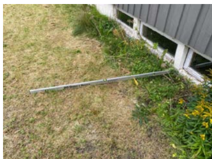
Fall på terrenget.
