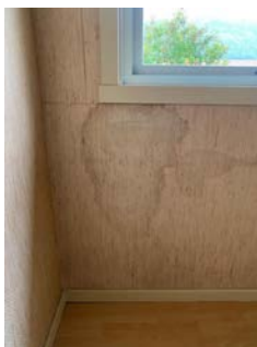
Fuktskade på vegg etter tidligere lekkasje.
