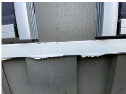
Avflasket maling på beslag under vinduer til stue.
