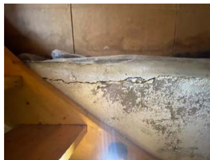
Fuktskader i plater/sprekk i betong på murkrone.
