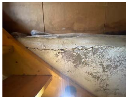
Fuktskader i plater/sprekk i betong på murkrone.
