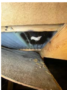
Ikke fagmessig tetting av yttertak.
