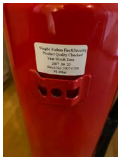
Brannslukkerapparat er eldre enn 10 år.
