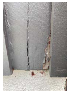
Råteskadd/opptrukket bordkledning mot øst.
