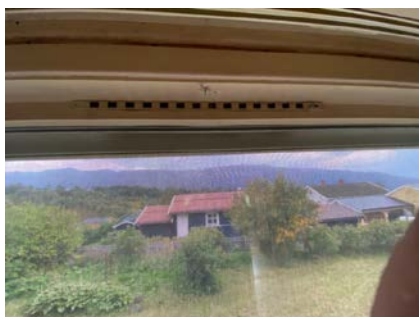
Ventiler i vinduer.
