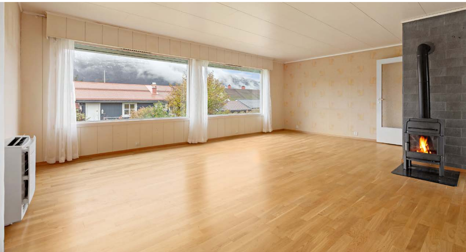
Det er installert varmepumpe av typen luft til luft fra 2021 av merket Daikin. Montert av PTG AS
