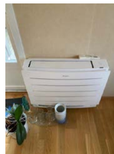
Varmepumpe, innvendig del i stue.
