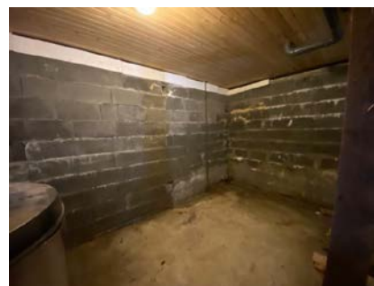
Saltutslag på vegger.
