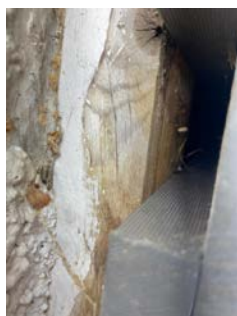
Manglende lusing/musebånd på vegg mot øst.
