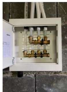
Fordelingsskap til bad fra 2017.
