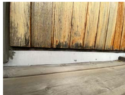
Råteskader i nedre del på døren.
