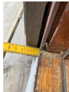
Glippe mellom utvendig omramming.
