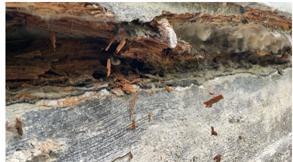
Råte i svill på bakvegg.
