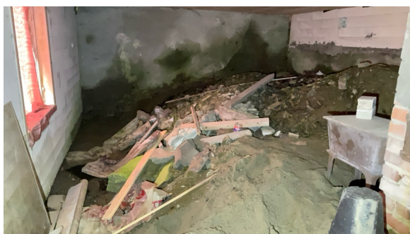
Leirholdige masser i krypkjelleren.
