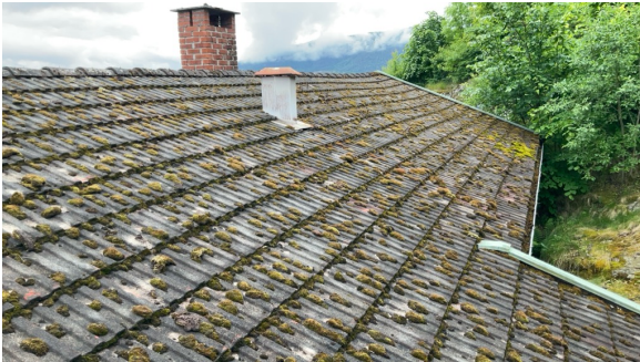
Gamle takstein er slitt og full av mose.
