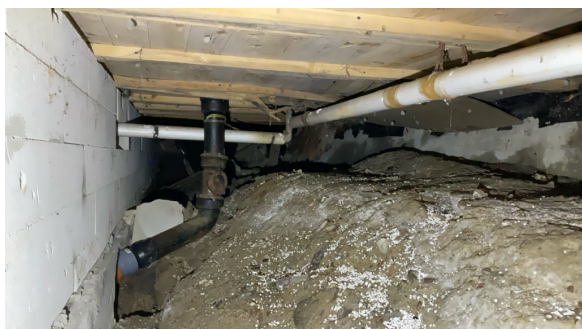
Råte i bjelker under stue og kjøkken.
