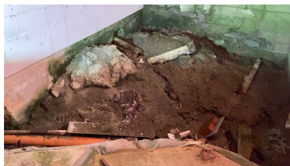
Jordfuktig masse i krypkjeller.
