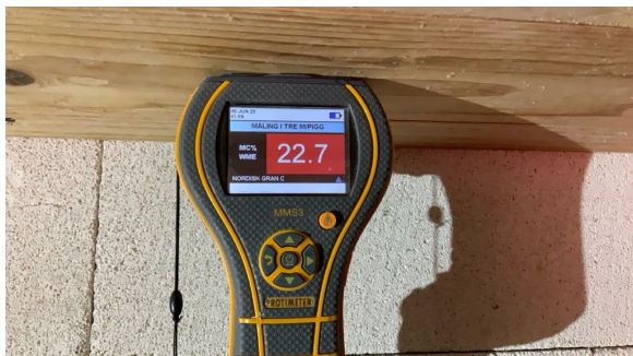
Fuktmåling i panel i krypkjeller.
