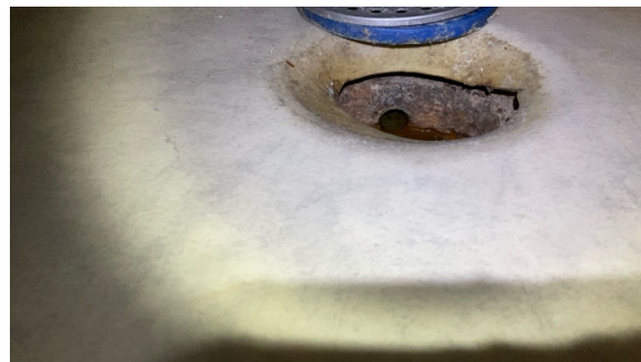
Sluk i støpejern med rust.
