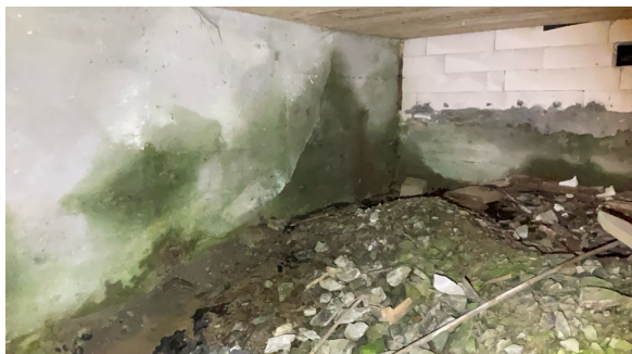
Fukt på vegger i krypkjeller.
