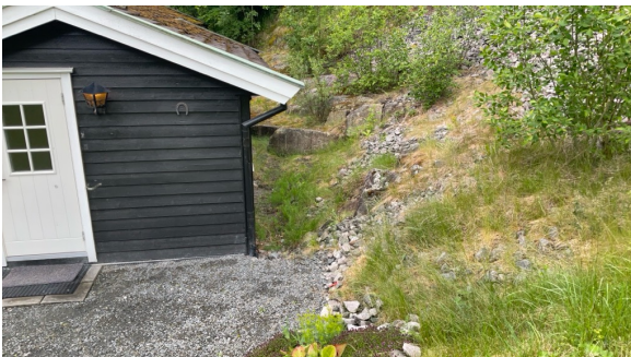
Fall på terreng mot boligen
