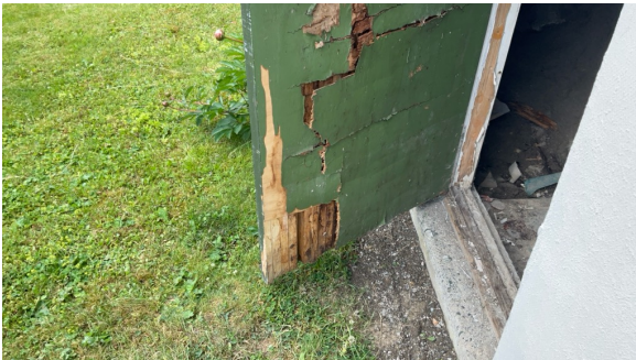
Råte i kjellerdør.
