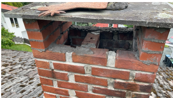
Pipe med luftekanal
