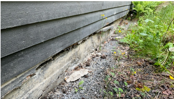
Råte i bakvegg.
