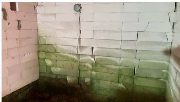
Sprekker i grunnmur.
