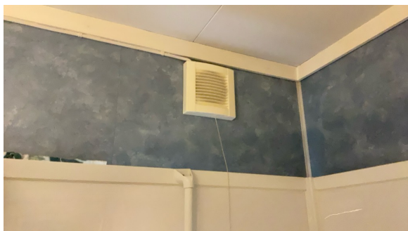
Vifte i vegg.
