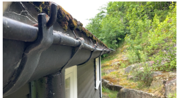
Skjevheter i takrenner.
