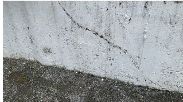
Sprekk i støttemur.
