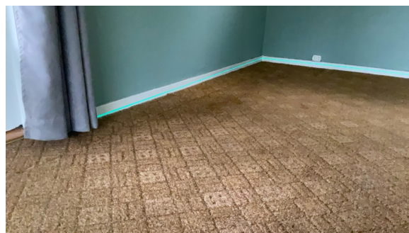
Skjevhet på bjelkelag i stue.
