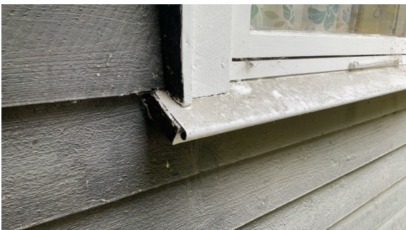
Vindusbelistning går helt ned til vannbrett.
