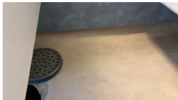
Våtromsplater uten forsegling ned mot gulv.
