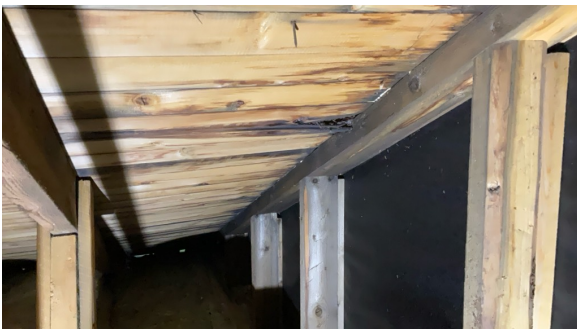
Råte i undertak hvor det mangler takstein.
