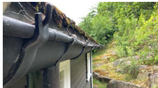
Skjevheter i takrenner.
