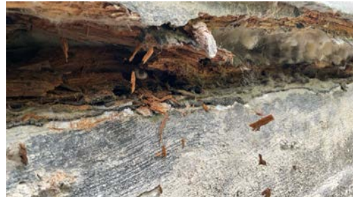
Råte i svill på bakvegg.
