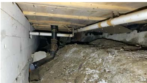
Råte i bjelker under stue og kjøkken.
