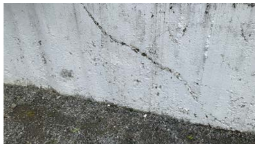
Sprekk i støttemur.
