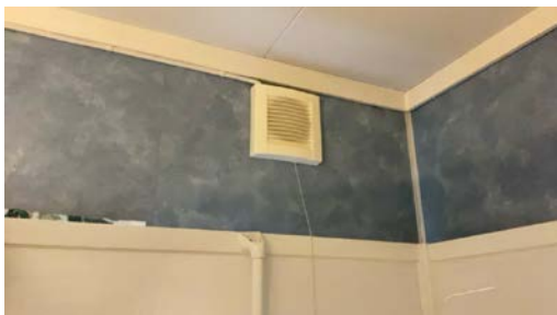
Vifte i vegg.
