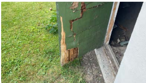
Råte i kjellerdør.
