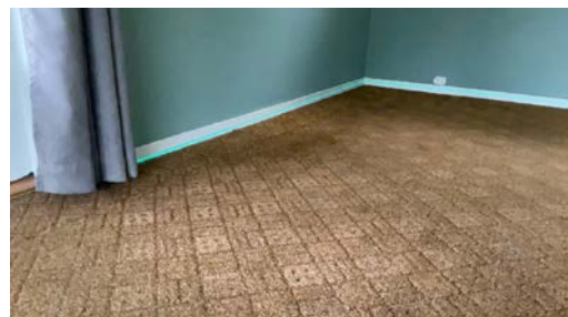
Skjevhet på bjelkelag i stue.
