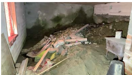
Leirholdige masser i krypkjelleren.
