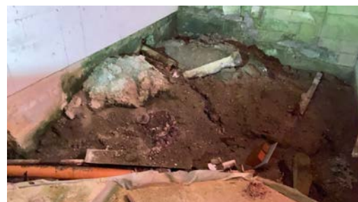
Jordfuktig masse i krypkjeller.
