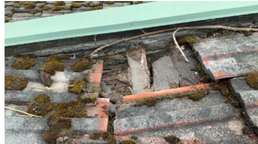
Manglende takstein har ført til råte i undertak.
