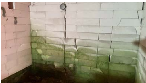
Sprekker i grunnmur.
