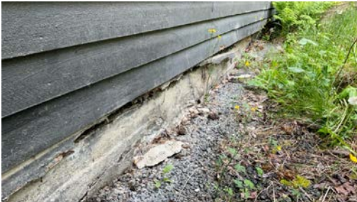
Råte i bakvegg.
