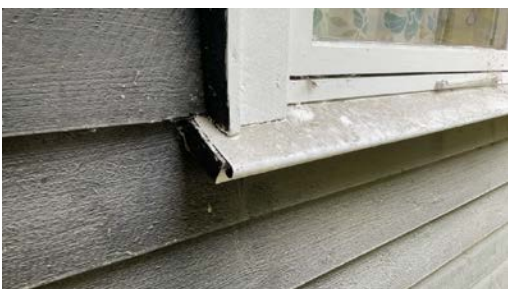
Vindusbelistning går helt ned til vannbrett.
