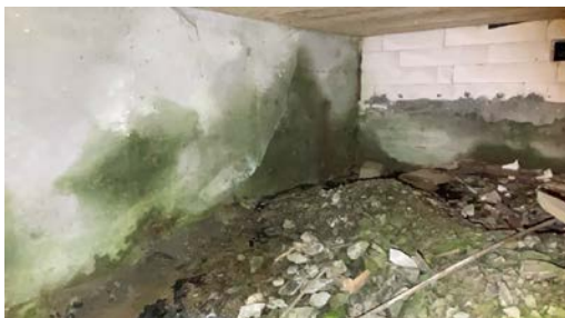
Fukt på vegger i krypkjeller.
