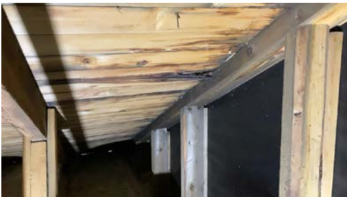
Råte i undertak hvor det mangler takstein.
