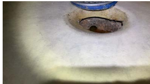
Sluk i støpejern med rust.
