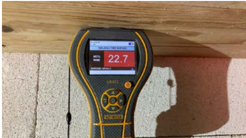
Fuktmåling i panel i krypkjeller.
