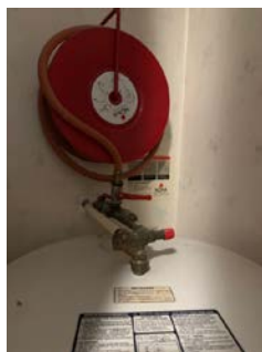
Hovedstoppekran er montert i skap på badetrom.
