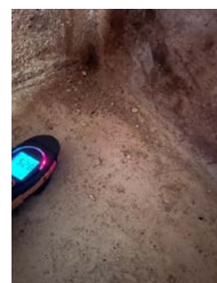
Det er registrert fukt på gulv mot terreng i kjeller.
