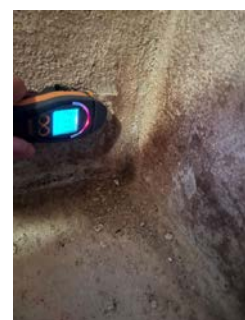
Det er registrert fukt i vegger mot terreng i kjeller.
