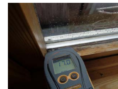
Det ble registrert noe forhøyet fuktverdier i noen vinduer.
