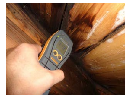
Det ble ikke registrert unormale fuktverdier i sutaket.
