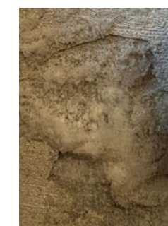
Saltutslag på vegger tyder på fuktighet i krypkjeller.
