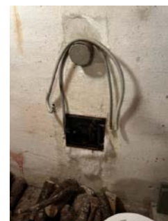
Saltutslag rundt feieluke i kjeller.
