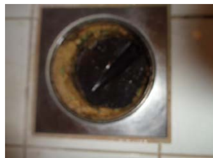
Plastsluk i dusjsone.
