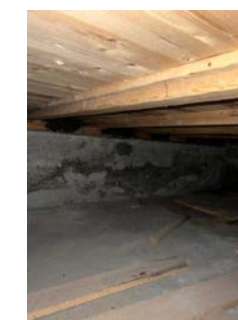
Saltutslag på vegger i krypkjeller.
