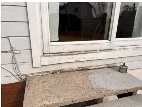
Råteskader i skyvedør 1 etg.
