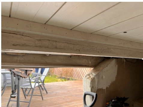
Råteskade i bjelker ned mot grunn (stubbloft)
