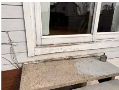
Råteskader i skyvedør 1 etg.
