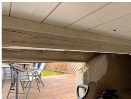
Råteskade i bjelker ned mot grunn (stubbloft)
