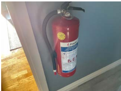
Brannsluknings apparat på soverom
