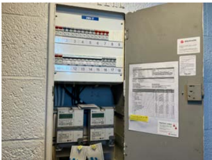
Sikringsskap i felles trappegang
