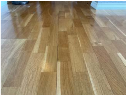
Sprekk i parkettsjøt i stue - gang
