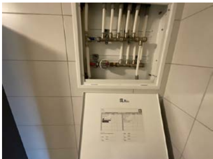
Rør i rør skap på baderom
