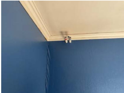
Rør for planlagt varmfordeling
