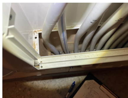
Ingen bunn i rørskapet.
