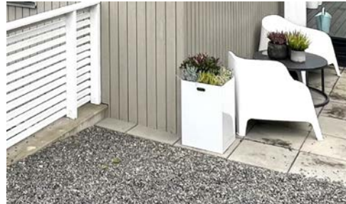
Trekledning ned mot grunnen.
