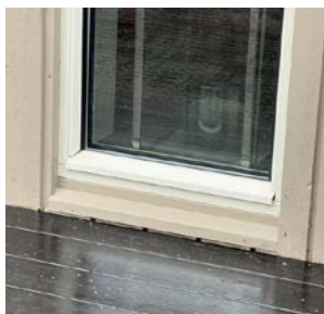
Vindu uten beslag på vannbrett.
