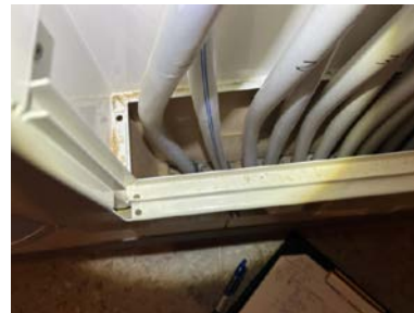
Ingen bunn i rørskapet.
