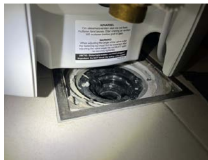
Sluk ved bereder.
