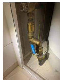
Stoppekran på bad, funksjonstestet ok.
