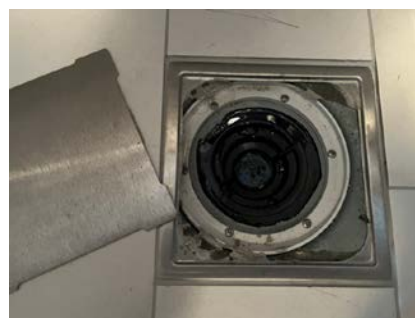
Sluk på toalettrom.
