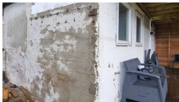
Grunnmuren har noe avskalling og manglende maling på deler av muren.
