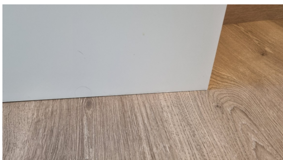
Dørblad subber i gulvet.
