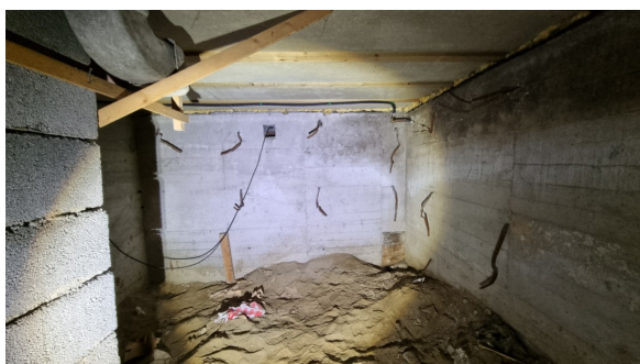
Det er manglende fuktsperre på bakken.
