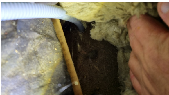
Utettheter rundt gjennomføringer.
