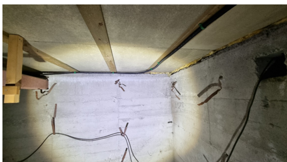
Det er registrert stubbegulvplater som inneholder asbest.
