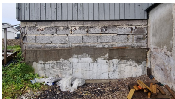
Grunnmur har sprekker og setningsskader.
