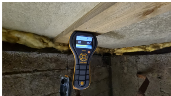
Fuktmåling i stubbegulv.
