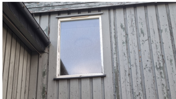
Utskifting av dette vinduet må påregnes.
