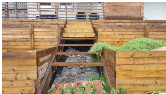
Trapp er ikke ferdigstilt.
