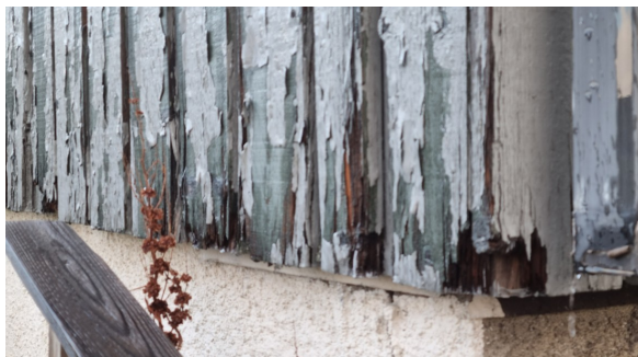
Bordkledning har råteskader
