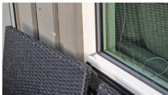
Det anbefales å overvåke området for eventuelle lekkasjer.
