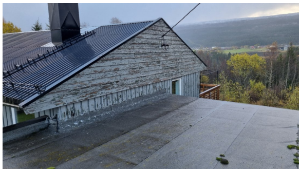
Det er påvist spredte råteskader i bordkledningen.
