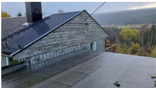
Det er påvist spredte råteskader i bordkledningen.
