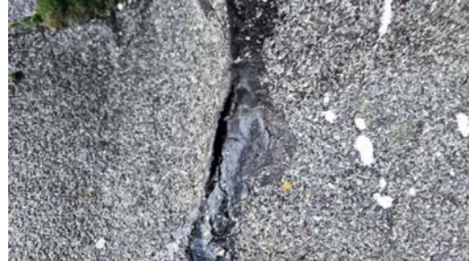
Det er registrert sprekk/utettheter i taktekke.
