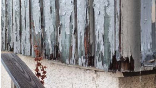
Bordkledning har råteskader
