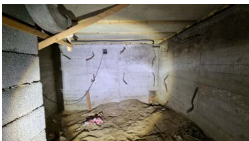
Det er manglende fuktsperre på bakken.
