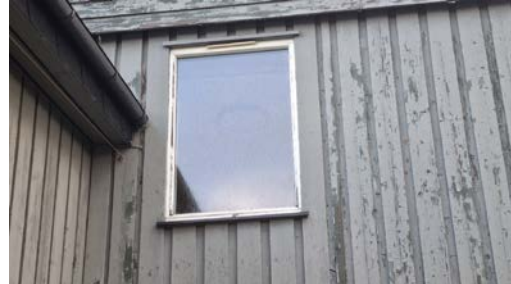
Utskifting av dette vinduet må påregnes.
