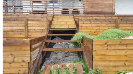
Trapp er ikke ferdigstilt.
