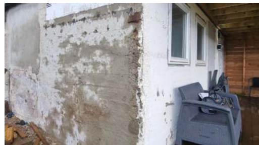
Grunnmuren har noe avskalling og manglende maling på deler av muren.
