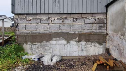
Grunnmur har sprekker og setningsskader.
