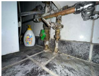
Eldre vannrør på bad med stoppekran
