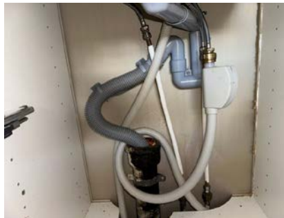
Røropplegg i kjøkkenbenk
